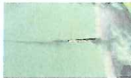
1-31 防水層の脆化 防水用ガラスマットの欠損部において進行
